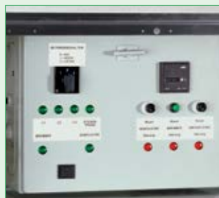
Schakelkast met bedrijfsuren- teller, beschermd ingebouwd
